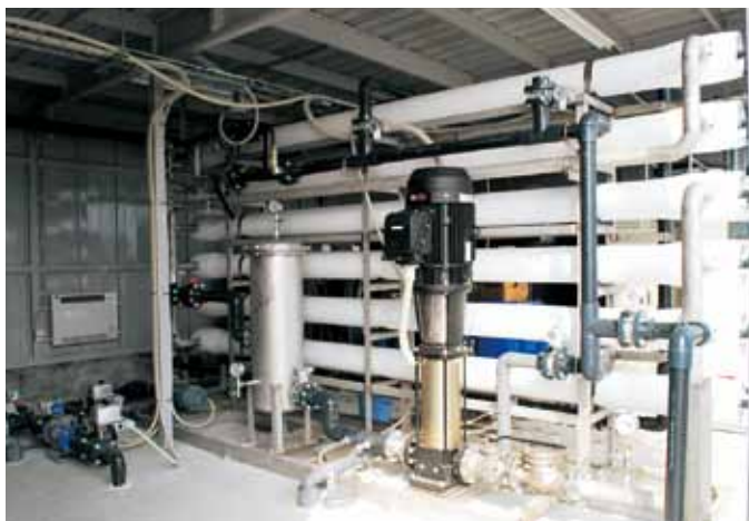
地下水供給設備
